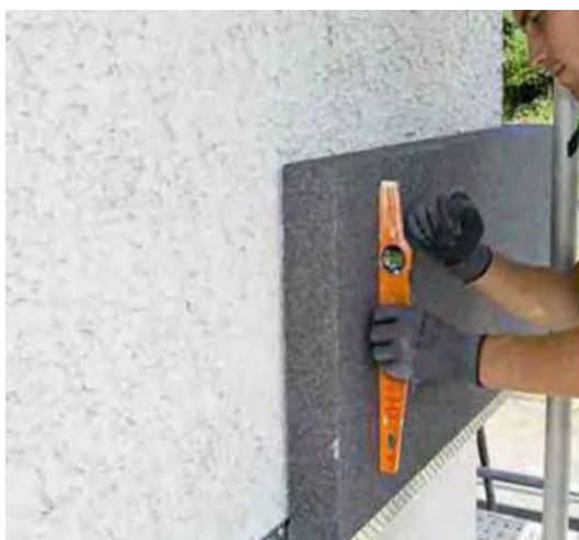
Het gebruik van een waterpas voor het leggen van Adam Materiaux EPS
