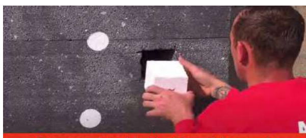
Passage du cable électrique à travers le blochet de l'EPS Adam Materiaux
