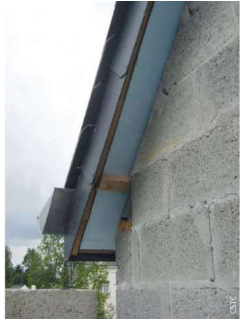
Aansluiting op de zijrand van een schuin dak (zicht op de aangebrachte isolatie vóór de gevelwerkzaamheden)
