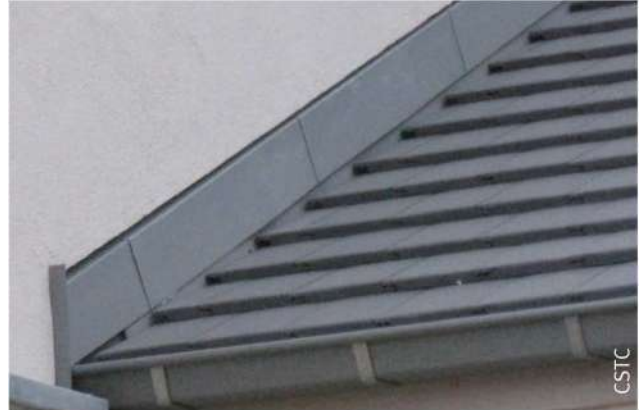
B. Ansicht nach der Montage der Abdeckung. Anschluss des Adam Matériaux ETICS am Anfang eines Steildaches
