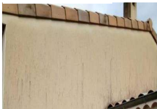
Źle umieszczony okap dachu
