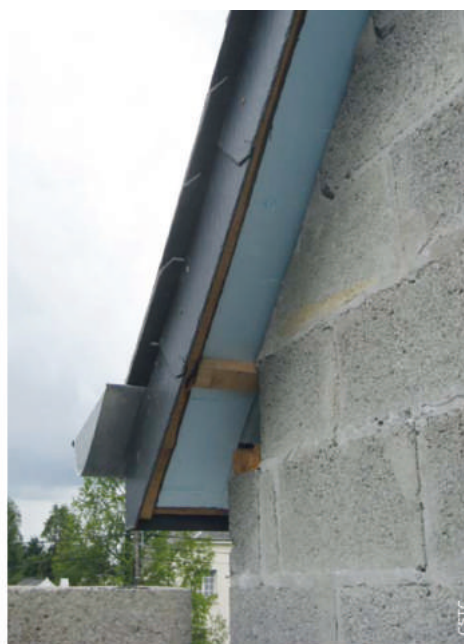
Raccord à la rive latérale d'une toiture à versants (vue de l'isolant interposé avant les travaux de façade).
