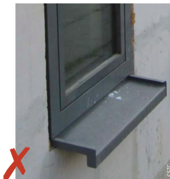
B. Non conforme à la PEB
