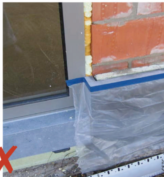
B. Non conforme à la PEB
