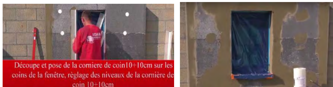
Même technique de pose de la cornière de coin de la façade LK PVC Premium 10x10cm autour des fenêtres et portes.
