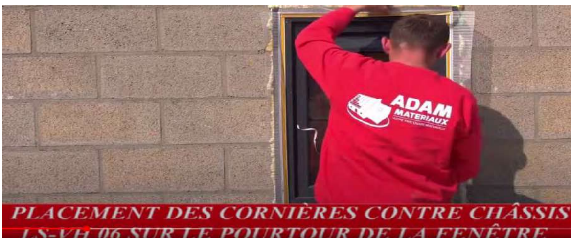
Pose des cornières LS-VH 06 6mm à minimum 2cm du bord des dormant de la fenêtre
