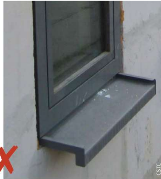
B. Non conforme à la PEB
