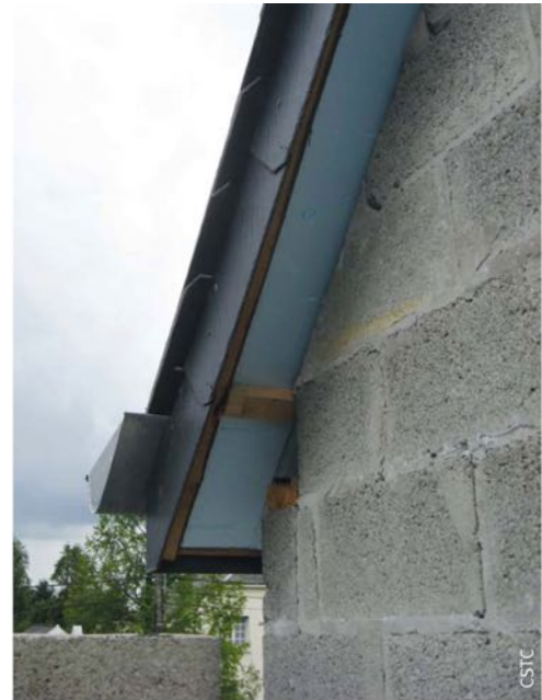
ETICS-verbinding met de helling van een hellingsdak (geval waar de ETICS aan het einde van de overschrijding komt)
