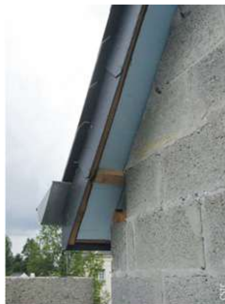
Raccord à la rive latérale d'une toiture à versants (vue de l'isolant interposé avant les travaux de façade).
