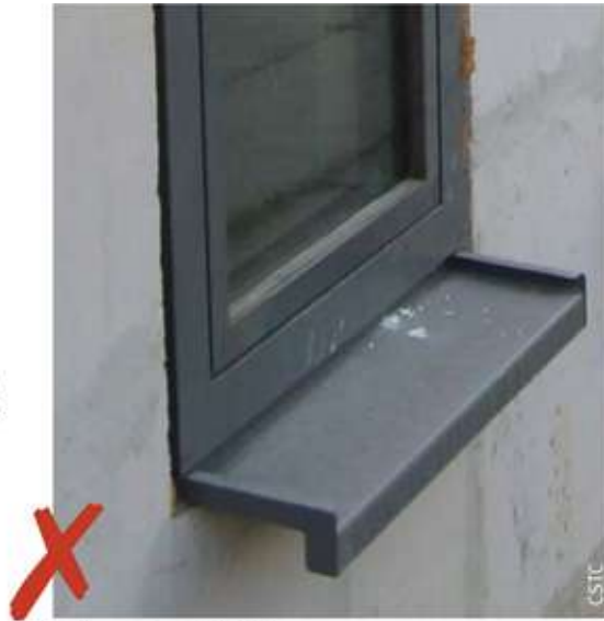
B. Non conforme à la PEB
